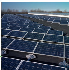
Ferme solaire de 1 600 kWp
