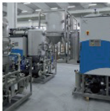
Propre station d'épuration
